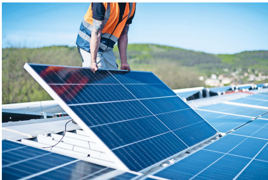
PV-Anlagen auf gemeindeeigenen Gebäuden sind ein wichtiges Element, um die Klimaziele zu erreichen. (Bilder: zvg.)
